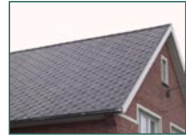
Ardoises en amiante-ciment
