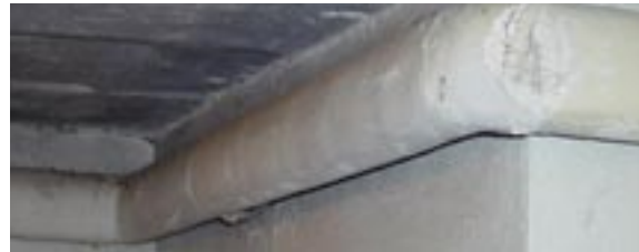
Exemple d'application friable : flochage d'isolation
