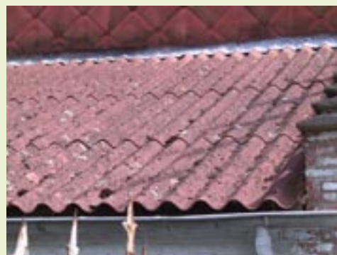
Plaques ondulées de toiture en amiante-ciment
